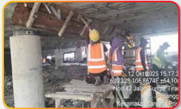
Penanganan Kebakaran Papanggo Handling of Fire at Papanggo
